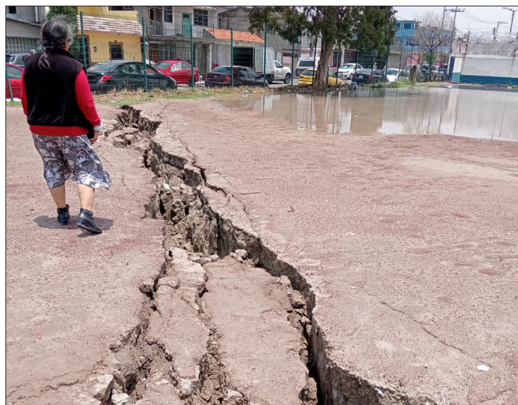
▲ La fisura tiene unos 25 metros de longitud y en algunos tramos hasta 30 centímetros de ancho. Foto especial
