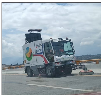
▲ Las labores consistieron en desalojo de agua y limpieza en pista de rodamiento. Foto especial
