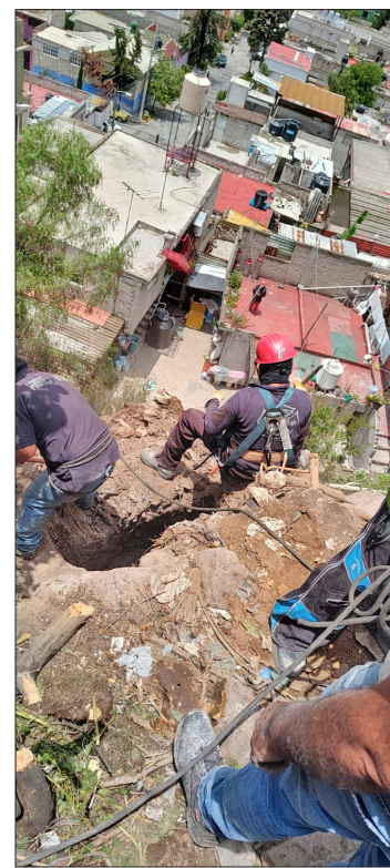
▲ Debido a los trabajos realizados por especialistas se evacuó a 50 personas de ocho viviendas. Foto especial
