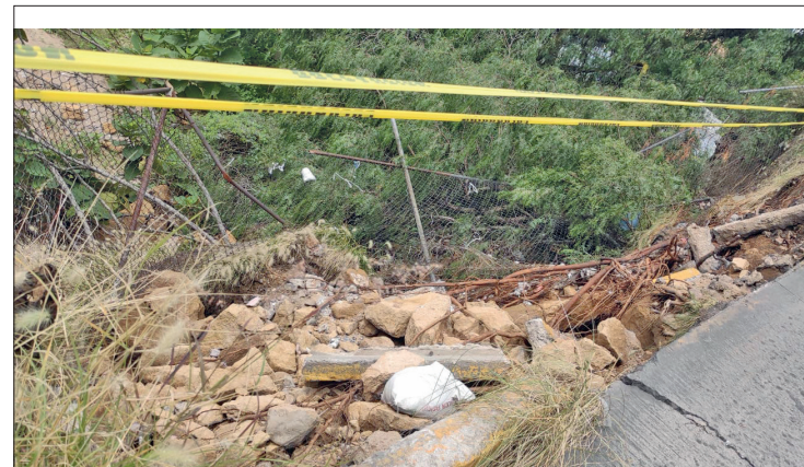
▼ Ante derrumbe en la calle Somasa, Protección Civil colocó amarilla y cerró parte de la vialidad para prevenir riesgos. Foto Alejandra Reyes
